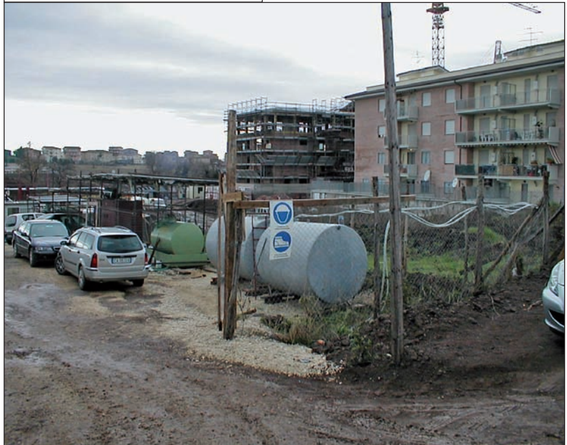
Serbatoio acqua non potabile
